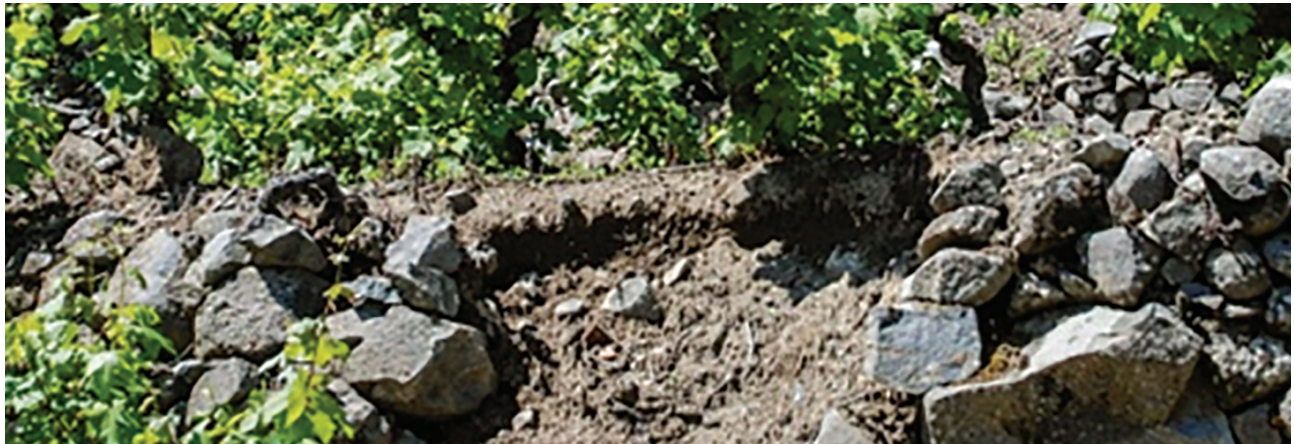
Şekil10: Bakım eksikliği nedeniyle çöken kuru taş duvar, yamacı toprak erozyonu ve arazi bozulması risklerine açık hâle getiriyor.
