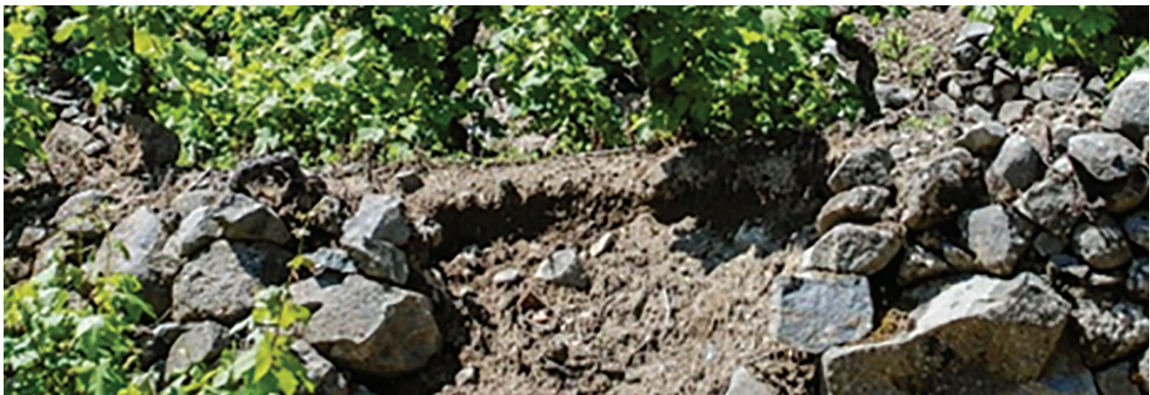
Figura 10: Muro de piedra seca que se derrumba
