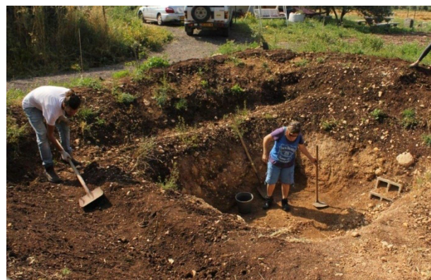
Figura 17: El equipo prepara el terreno para el establecimiento de un estanque ecológico.
