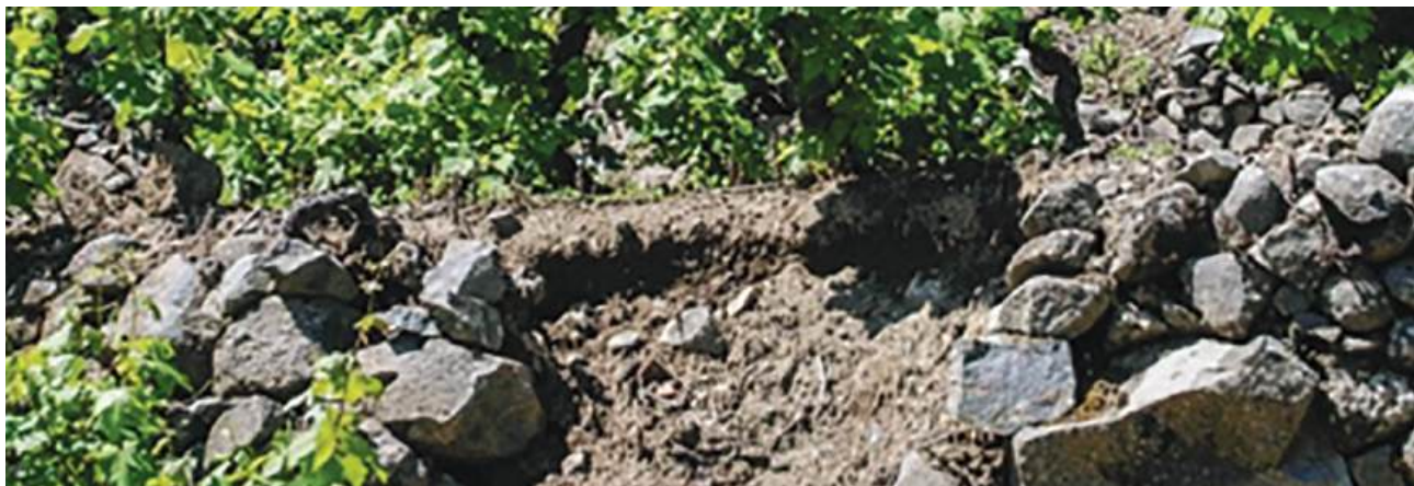
Figura 10: Muro de piedra seca que se derrumba
