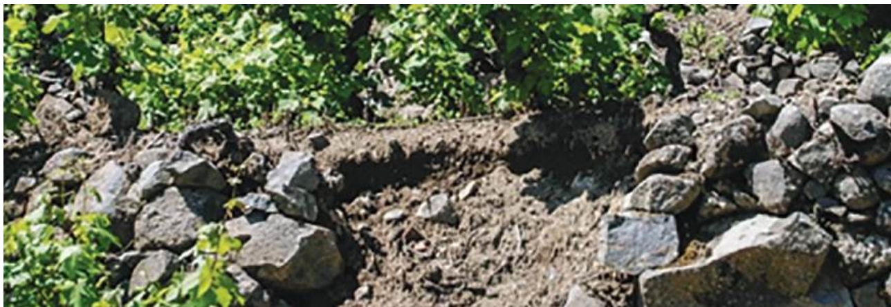
Εικόνα 10: Τοίχος από ξερολιθιά που καταρρέει
