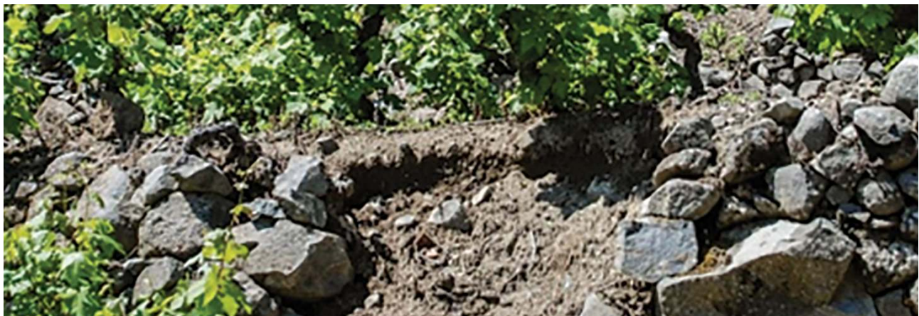
Figura 10: Mur de pedra seca esfondrat
